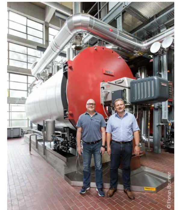
Planung Energiezentrale Kantonsspital St. Gallen: Neuer Spitzenheizkessel mit zufriedenen Kunde
